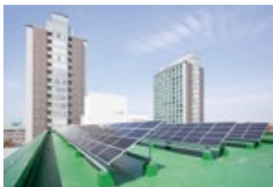
4号館屋上の太陽光発電設備
